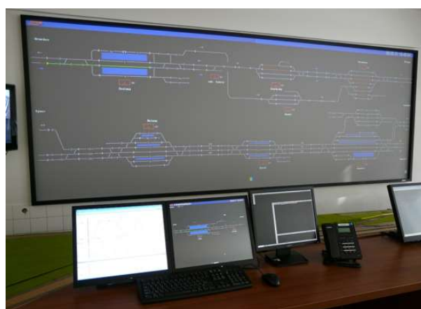
Obr. 5 Jednotné obslužné pracoviště (JOP) elektronického zabezpečovacího zařízení
